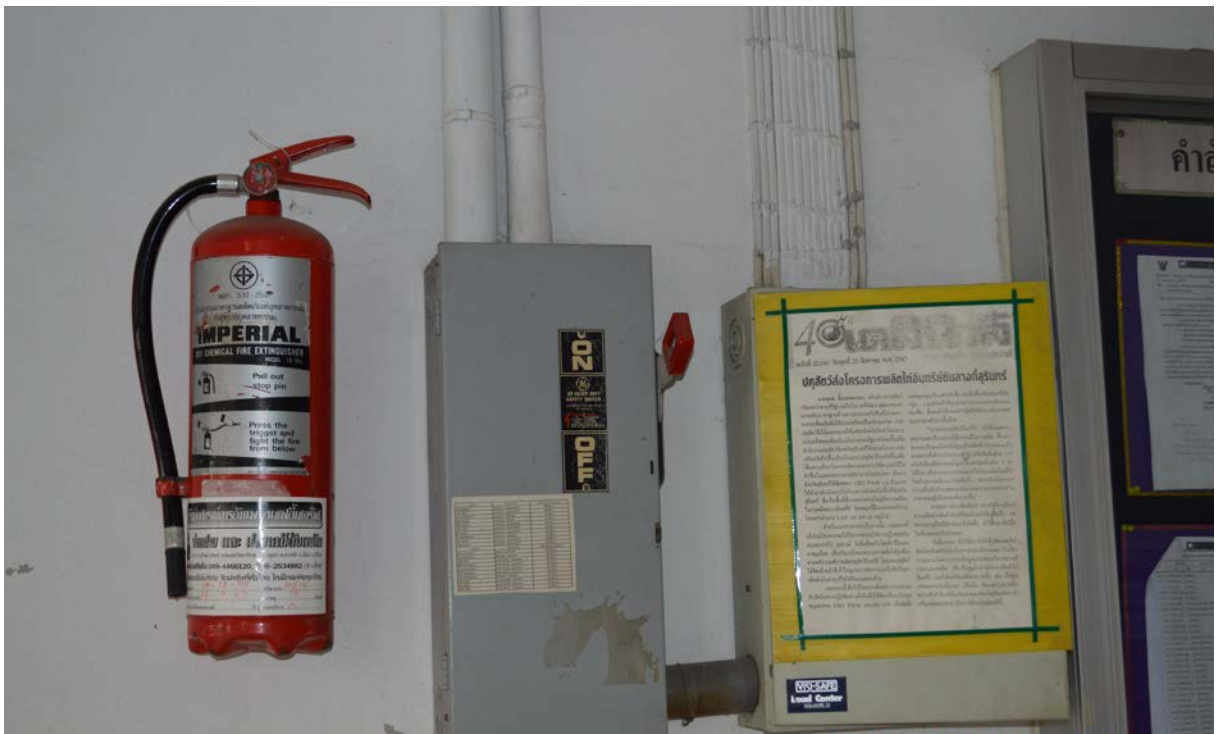
ถึงดับเพลิงจุดที่ ๒ ติดตั้งที่บริเวณหน้าห้องประชุมสำนักงานฯ (ชั้นล่าง)
