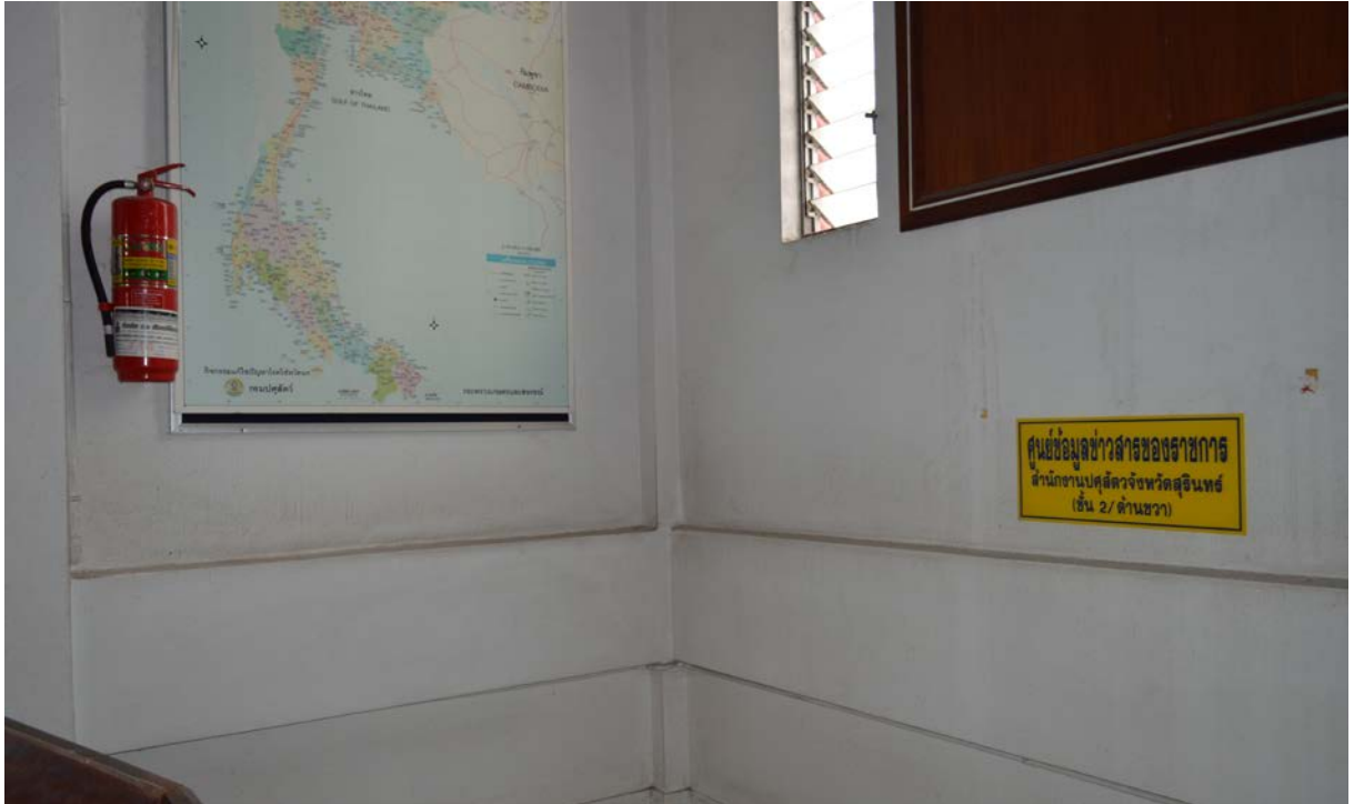
ถึงดับเพลิงจุดที่ ๑ ติดตั้งที่บริเวณทางขึ้นชั้นบนอาคารสำนักงานฯ
